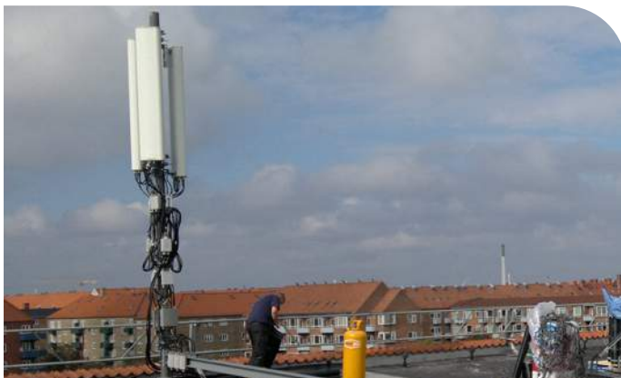
Sendemaster skal være slukkede, når der bliver arbejdet i nærheden
